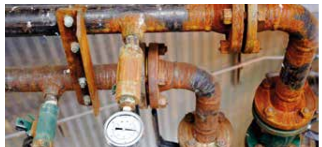
Figur 18 Inddrages det personale, der vedligeholder anlægget, kan der fremkomme værdifulde oplysninger om eventuel korrosion og begroinger eller belægninger omkring følere.
