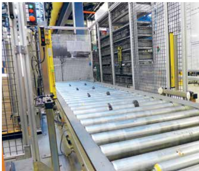
Rullebane sikret mod, at personer kan gå ind i robotcellen vha. lysbom og kryds: Når en palle skal passere, mutes (slukkes) lysbummen, og den tændes automatisk igen umiddelbart efter, pallen er passeret.
