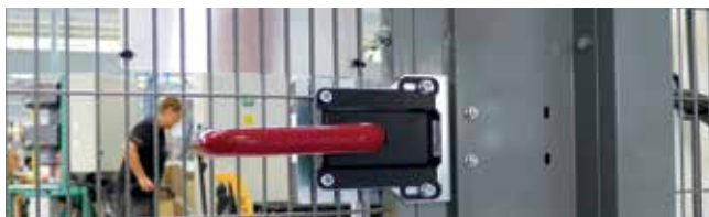
Dørlås set inde fra en robotcelle. Man må aldrig kunne blive lukket inde i en maskine. Denne dørlås kan ikke låses eller blokeres
