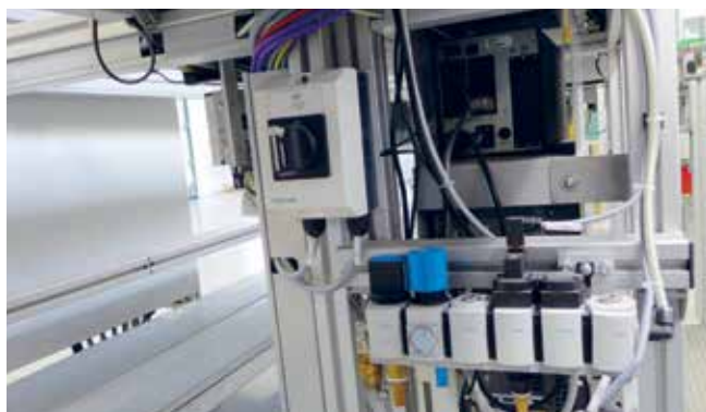
Forsyningsadskillere for trykluft og el placeret samlet. Hvis begge er åbnet og aflåst, vil det normalt være helt sikkert at arbejde inde ved robotten. Kun hvis opgaven ikke kan udføres uden trykluft eller elforsyning, kan det i nogle tilfælde tillades at arbejde inde i robotcellen, mens robotten arbejder.
