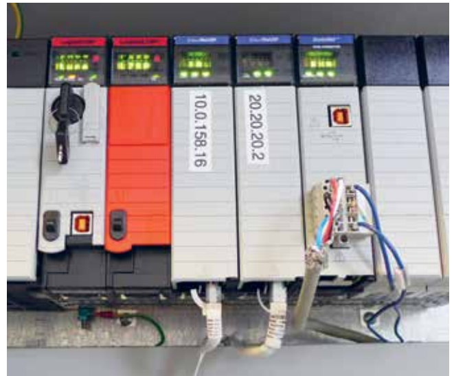
PLC med et enkelt sikkerhedsmodul. Sikkerhedsrelæer og sikkerheds-PLC'er har normalt en anden farve, gerne rød eller gul. Men kontroller alligevel dokumentationen for at være helt sikker.
