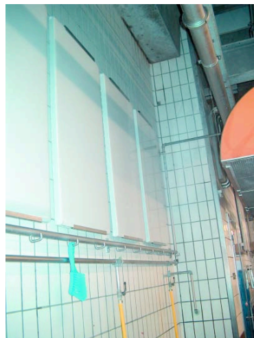
Ventileret absorbent monteret i skinnesystem, hvor den let kan nedtages for rengøring og kontrol.
