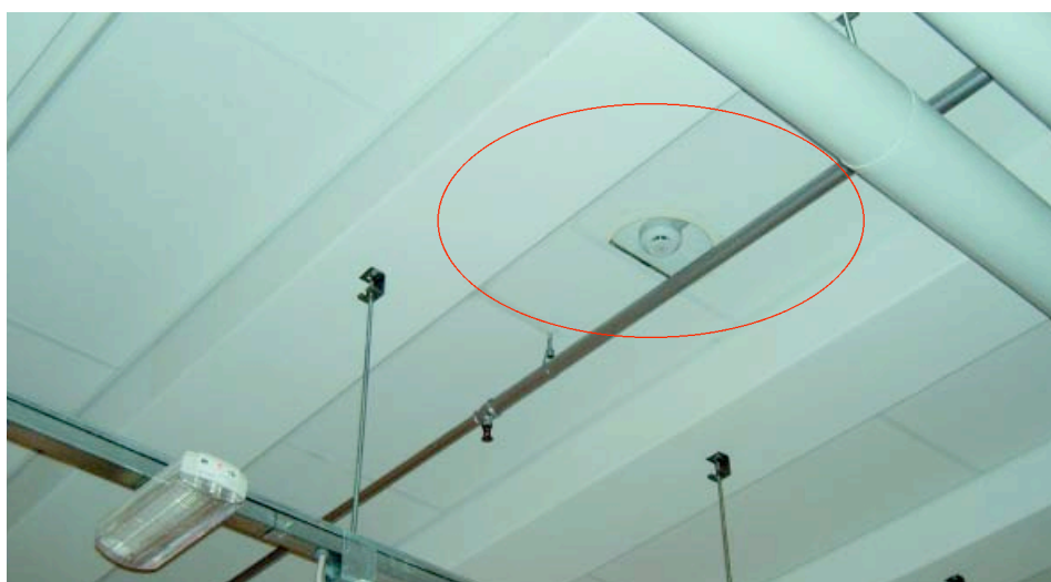
Loft monteret over sprinkler. Areal omkring brandmelder er friholdt.
